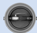
Regard bloc clapet-vanne
