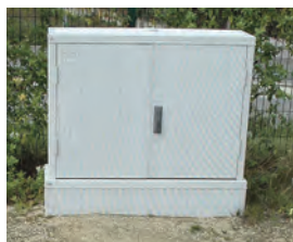
Coffret de commande et de télégestion en armoire
