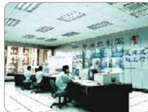
Centre de contrôle
